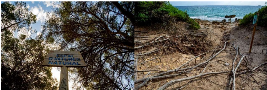
Fotos. Senyal d'espai d'interès natural, i àrea de dunes degradada per l'ús públic i les pluges torrencials a la Punta de la Creueta. Font: ©Ferran Aguilar
